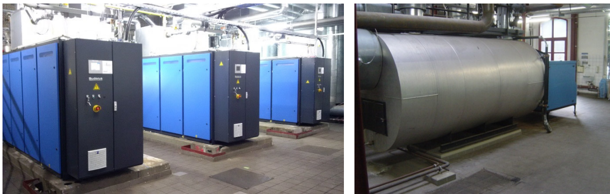
Abb. 17/18: BHKW-Module und Warmwasserkessel im Kesselhaus
