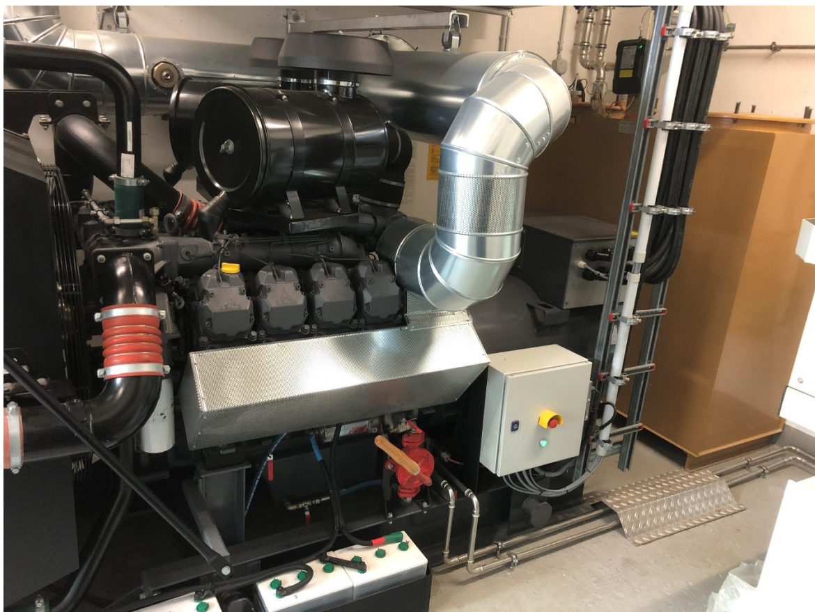
Abb. 20: Notstromaggregat im Haus 26
