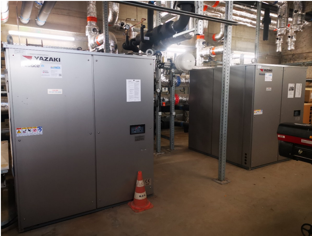
Abb. 21: Absorptionskältemaschinen im Untergeschoß Haus 4
