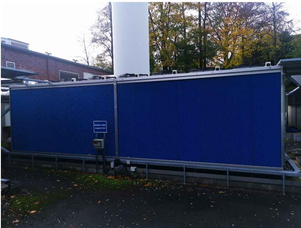
Abb. 22: Rückkühlwerk auf dem Hof vom Kesselhaus (Haus 4)
