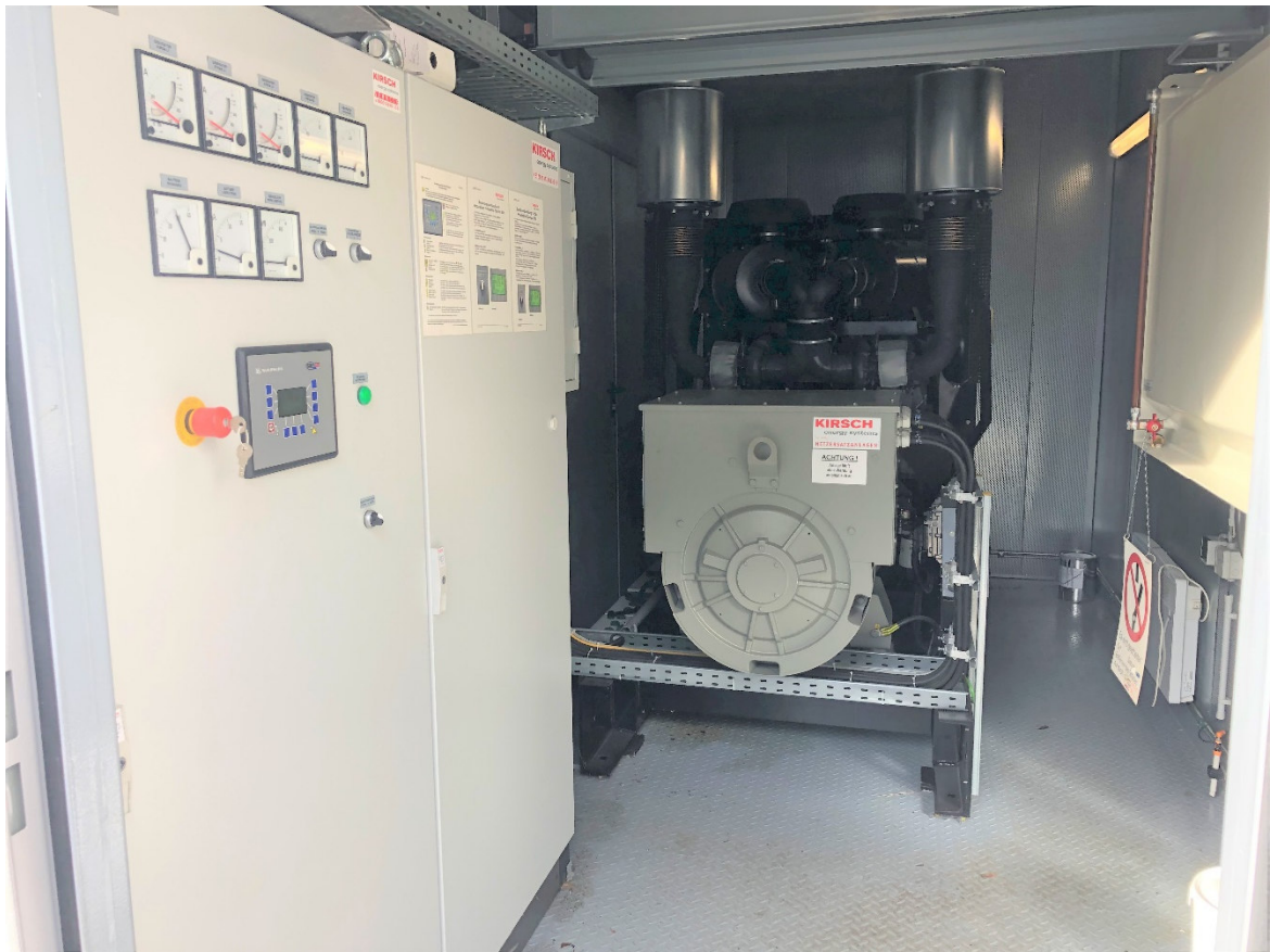
Abb. 19: Notstromaggregat bei Haus 4
